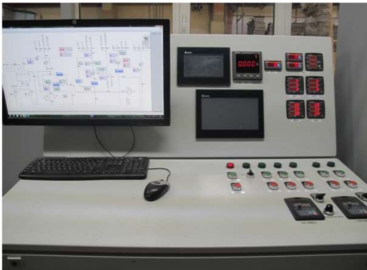
Пульт управления стенда испытаний приводов ИМ СУЗ
